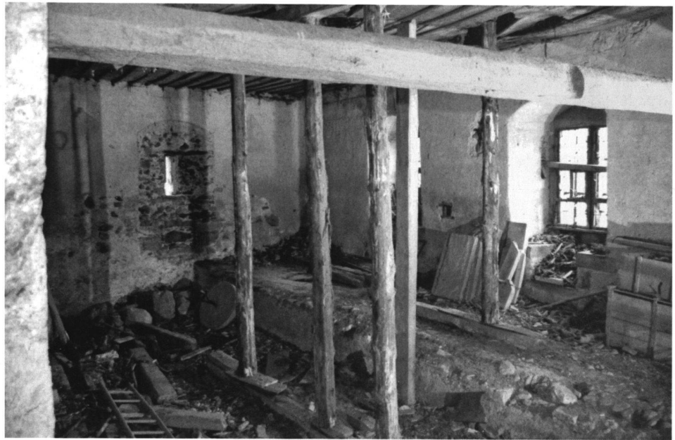
4: Der Ritteraal mit notdürftig abgestützter Decke 1978.
