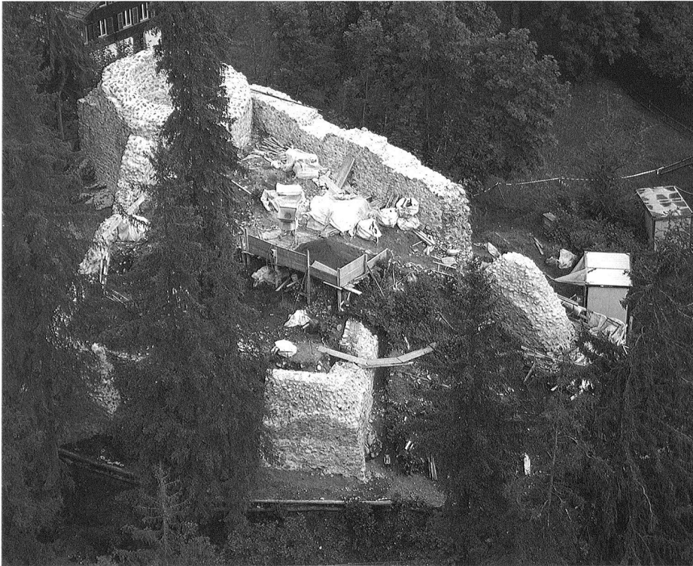
Abb. 9: Unterer Mannenberg. Die Burganlage während der Sanierung. Im Vordergrund der Sockel des Wohngebäudes und links davon der Steilhang zwischen oberem und unterem (weitgehend verschwundenem) Burghof, der von der steil abfallenden Ringmauer abgeschlossen wird. Im Hintergrund der Rundturm; darunter ist die Nordecke des mutmasslichen rechteckigen Turmes sichtbar, auf dem der jüngere Rundturm aufsitzt. Luftaufnahme, Blick von Südwesten.
