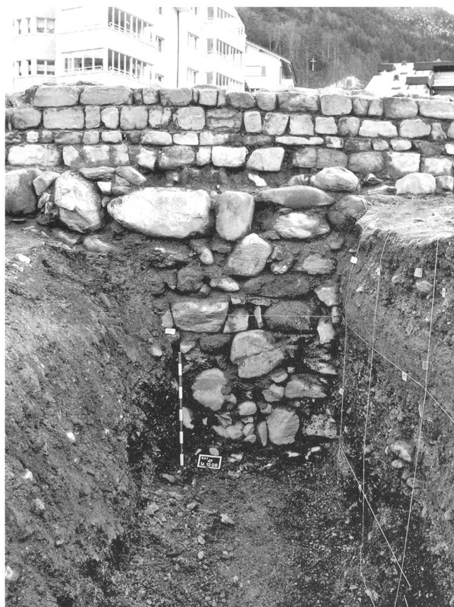
8: Blick von Westen in die Sondage bei Profil 1 und an die Turmmauerfassade mit Fundament.
