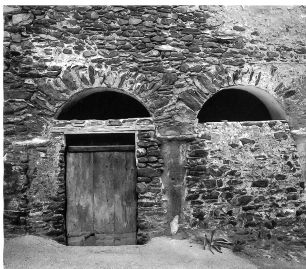
7: Maison Guerrati, façade nord. Détail de l’arcade avant les travaux de rénovation – Detail der Arkaden in der Nordfassade vor der Renovation.
