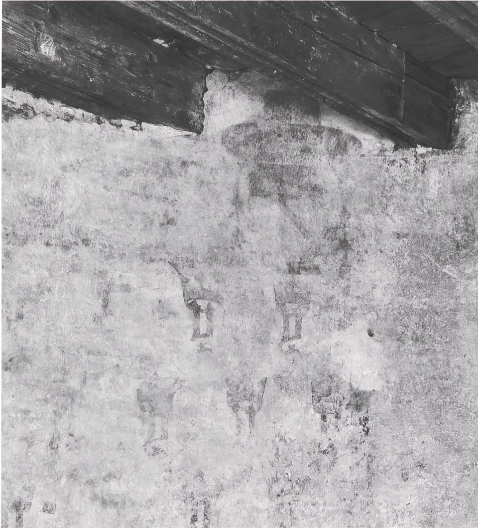
11: Lausanne, Saint-Maire. Tourelle sud-ouest après conservation des décors. Détail du bandeau orné de quadrilobes.
