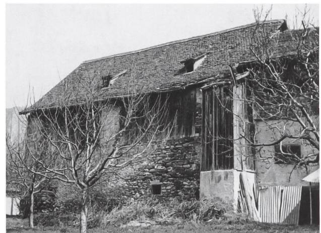
14: Zizers. Das Obergeschoss des Torkels von 1754d ist als Pfeilerbau errichtet, die Zwischenräume sind mit Bretterwänden geschlossen. Blick gegen Osten.
