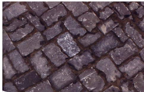
Pavage irrégulier posé en diagonale réalisé en première avec des pavés en grand format au jardin zoologique de Goldau (SZ) en 2006.
