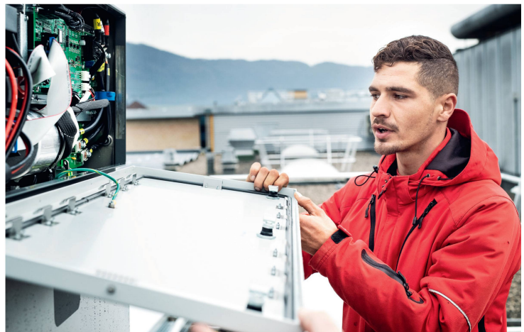
L'installation solaire permet d'être presque autonome en termes d'énergie.
