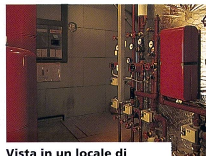
Vista in un locale di riscaldamento di un impianto a collettori solari. Tecnica maturata e rifiniture pulite fanno parte oggi dello standard.
