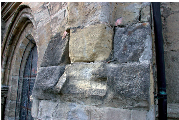
1,2 Cathédrale de Lausanne, dégradation de la molasse au niveau du chœur (Photo Bureau Christophe Amsler).
