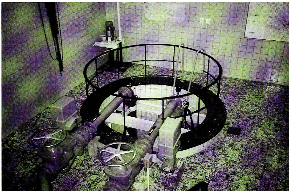
Abb. 4: Entnahmeschacht des Pumpwerks II der Wasserversorgung Sursee. Die beiden installierten Pumpen haben eine Förderleistung von 3000 und von 2500 Litern pro Minute.
