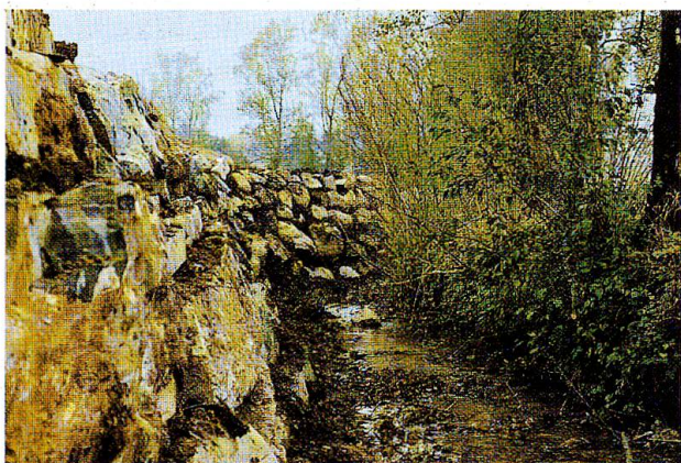
Abb. 13: Sellenbodenbach, Gemeinde Neuenkirch: illegale Uferverbauung, 28. 10. 1991.
