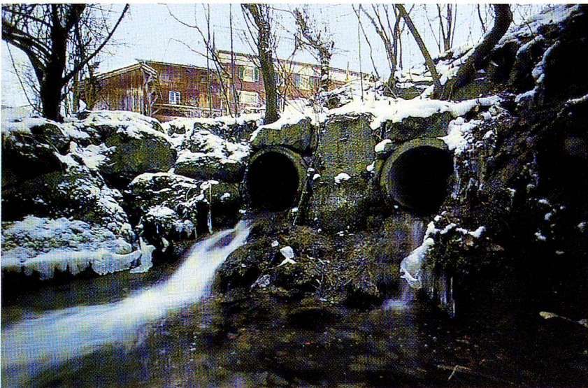
Abb. 7: Herrenmühlbach bei Herenmüli, wo er in Röhren verschwindet. Diese künstlichen Abstürze und Verrohrungen verhindern die Durchgängigkeit für Wasserorganismen.
