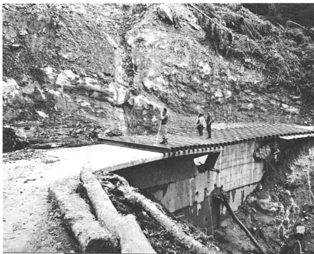
Hinter-Erlibach III nach der Räumung und der Montage der Stahlträger zur Überbrückung der zerstörten Brückenplatte.
