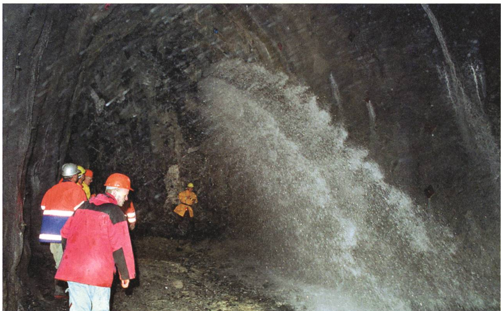
Nach 1,7 km im Tunnel- Nordvortrieb wurde die Quintner-Kalk-Zone erreicht. Das Wasser schoss aus vier Bohrlöchern bis 22 m weit in den Tunnel.
