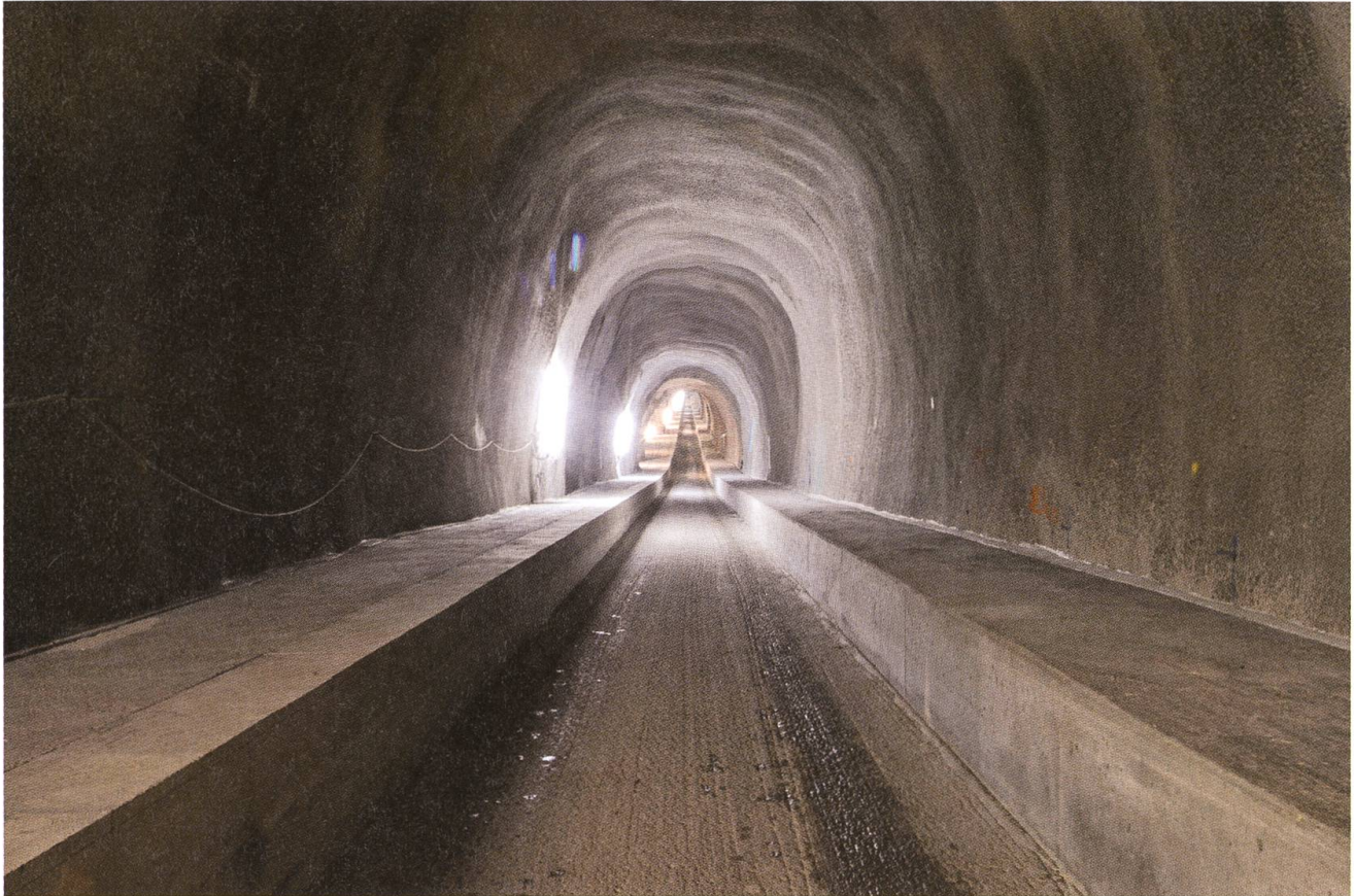
Parat für die Schienen: Der Tunnel im Rohbau kurz vor dem talseitigen Nordportal.
