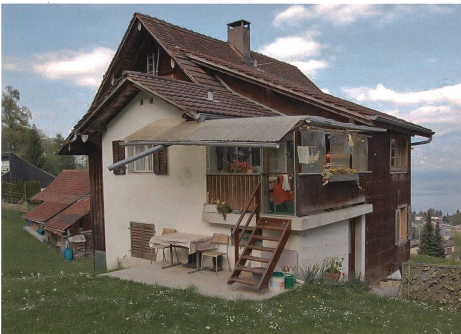
Vorher: Altes Bauernhaus in Hergiswil, renovationsbedürftig.
