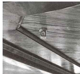
Die in die Holzdecke harmonisch integrierte Sprinkleranlage.
