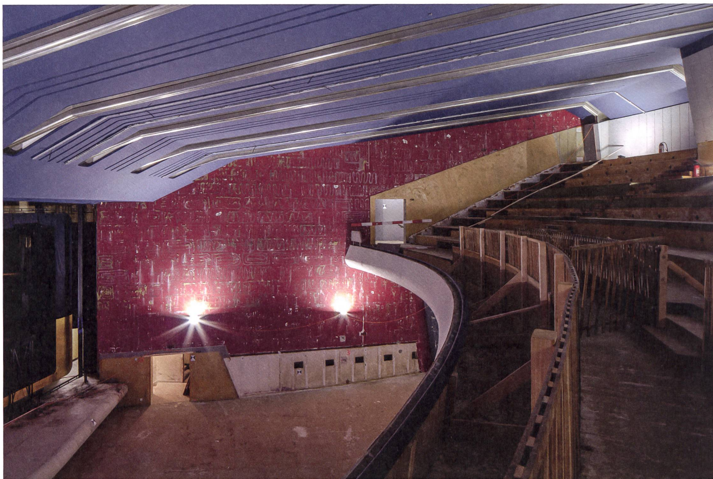
Fig. 11 Vue actuelle, depuis le balcon. On sent fortement la présence des six fermes en aluminium de la charpente. © Michel Giesbrecht, 2020
