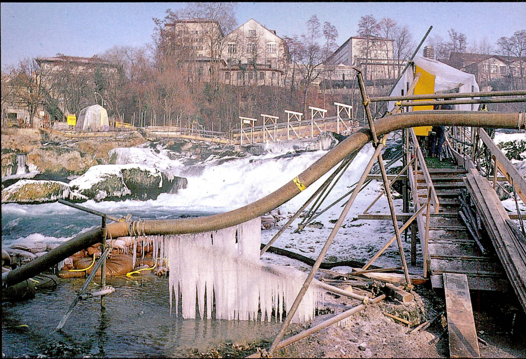
Abb. 16 Spritzbetontransportleitung vom Neuhauser Ufer aus
