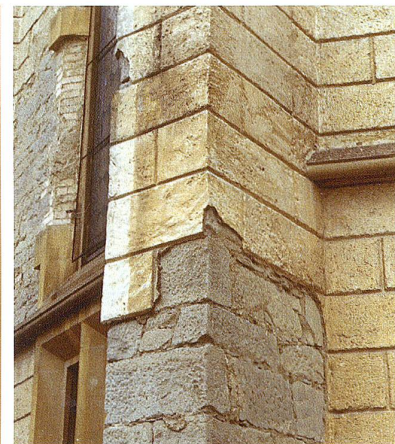
Bauliche Mängel bereits nach wenigen Jahren: abgebrochener Verputz an der Fassade der Schutzengelkirche.
