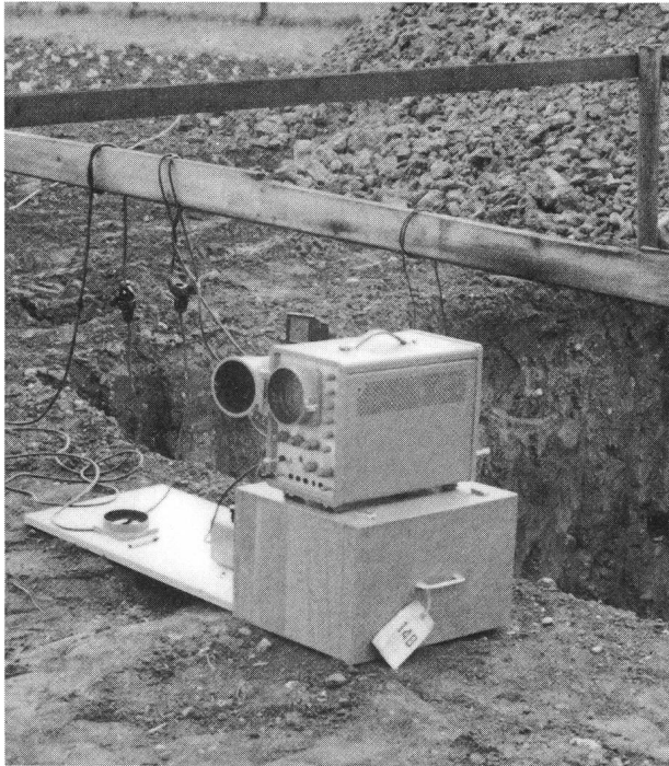
Fig. 2: Um nicht durch unerwartete Bodenerschütterungen durch die 200 m entfernte Bahnlinie überrascht zu werden, wurden ausführliche Vorabklärungen unternommen.
