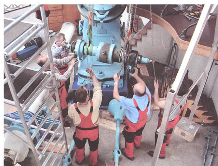
Fig. 11: Obwohl dem ganzen Fernrohr auch nach hundert Jahren Betriebszeit ein guter Zustand attestiert werden kann, hat der Zahn der Zeit dennoch seine Spuren hinterlassen.
