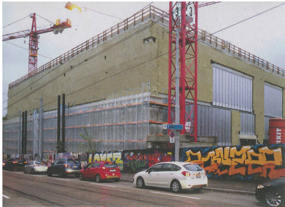
Der Erweiterungsbau des Kunsthauses Zürich in Steinwolle gekleidet, kurz vor der Montage der Kalksteinfassade
