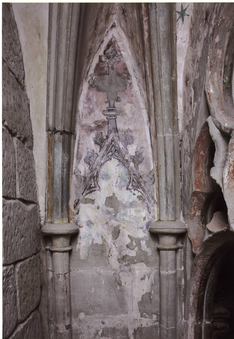
Fig. 70 Enfeu présumé de l'abbé Petrus Dives. La restauration du début du XX e siècle a créé un contraste entre le décor peint de 1320-1330 et le mur du fond de la niche. Abb. 70 Grabnische, vermutlich des Abts Petrus Dives. Die Restaurierung des frühen 20. Jahrhundert schuf den Kontrast der Malerei von 1320/30 zum Mauerwerk der Nischenrückwand.
