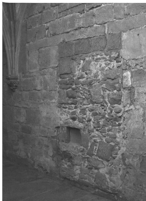
Fig. 28 Ancien accès gothique à l'aile des convers depuis le passage d'entrée au cloître. Abb. 28 Vermauerte gotische Tür vom Eingangsfur des Kreuzgangs in den Konversenflügel.
