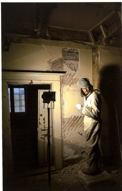
Fig. 127 WIP (Work in progress): l'analyse et l'enquête au service d'un projet architectural évolutif. Sondages et dégagements dans le couloir du 1 er étage.
