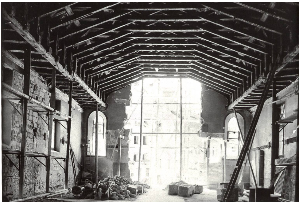
Fig. 167 Rénovation de la nef de l'église Saint-Jean en 1951, après démolition de la tribune et de la galerie des prisonniers dont on distingue encore tout à droite la porte d'accès, liant autrefois l'église à l'hospice et à la commanderie (BCUF, Fonds Johann et Jean Mülhauser).
