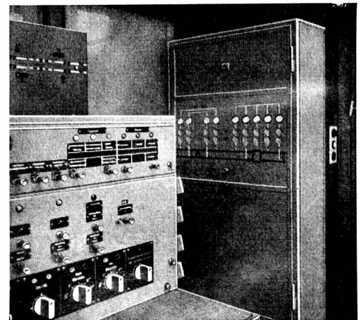
Fernsteuerungsanlage, Bahnhof Göschenen
