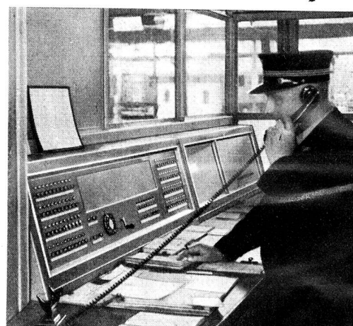
ALBIS-Telephon-Anlage bei den SBB
