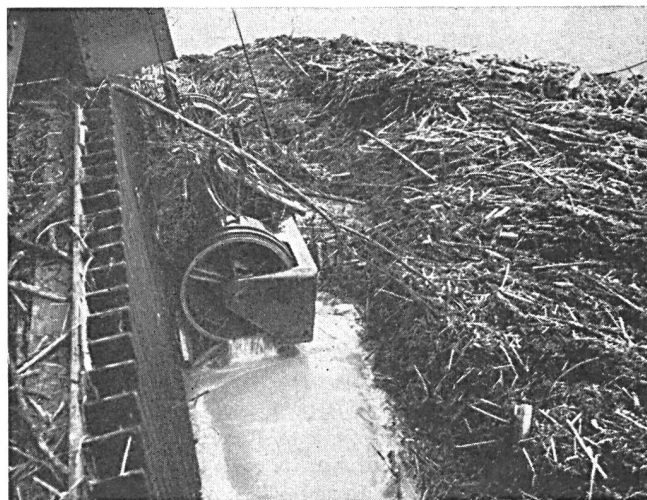
Abb. 4. Geschwemmelwalze (Hochwasser), Kraftwerk Birsfelden.
