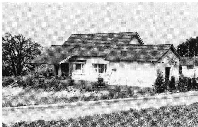
Abb. 5. An Einfamilienhaus angebaute Transformatorstation in Uitikon.
