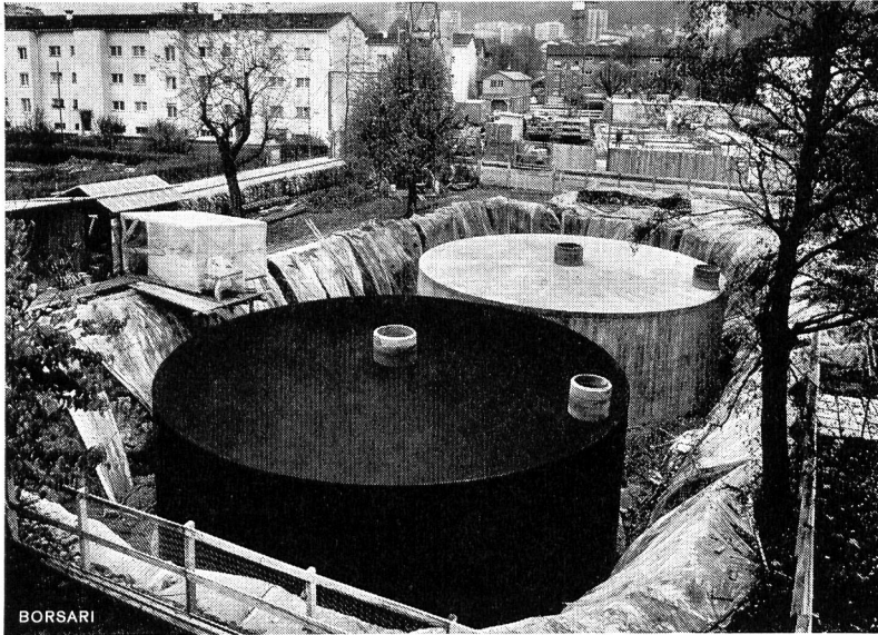
Gemeinnützige Baugenossenschaft Limmattal, Zürich 2 Tanks, total 1 000 000 Liter Heizöl
