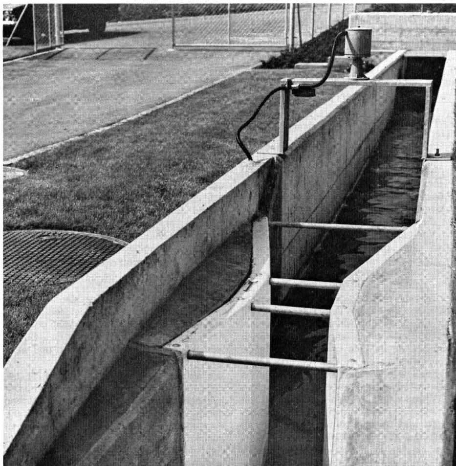
Abb. 1. Der Messgeber, über dem Venturikanal angebracht, strahlt ein Schallsignal aus, das von der Wasseroberfläche als Echo zurückgeworfen wird
