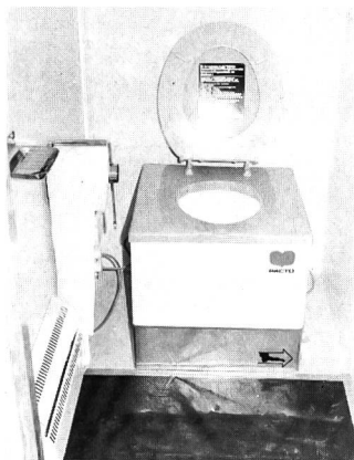
Pacto 203 in Baustellentrailler installiert
