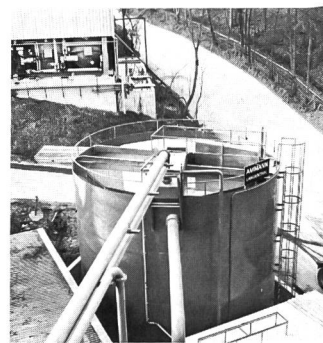
Ammann-Schlammwasserkläranlage KA 75 installiert in Kieswerkbetrieb
