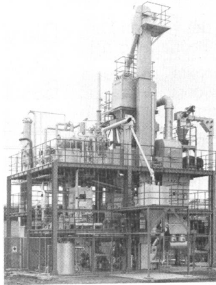
Klärschlamm-Verbrennungsanlage in Kyoto/Japan.
