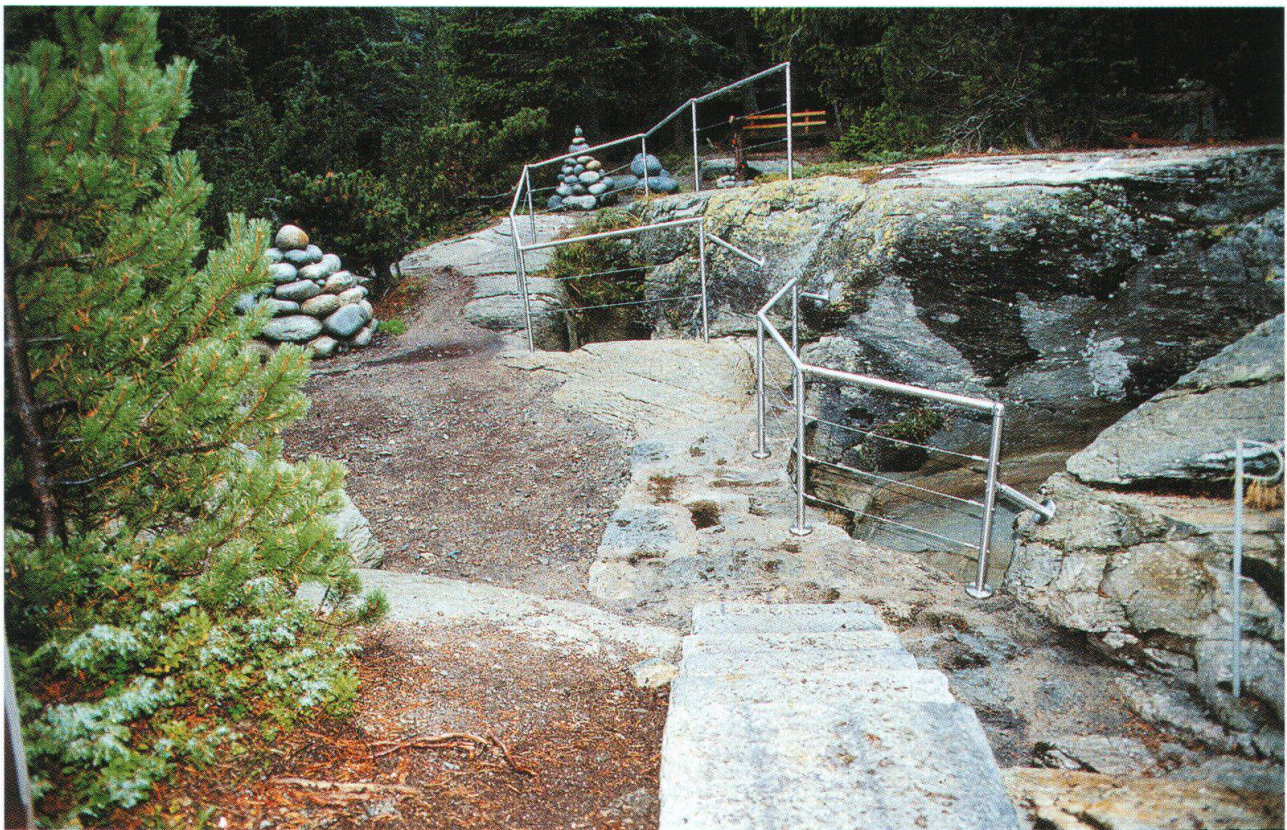
Un'apposita ringhiera in alluminio attorno alle marmitte, che si adatta perfettamente nell'ambiente naturale, è una necessaria protezione per evitare incidenti.
