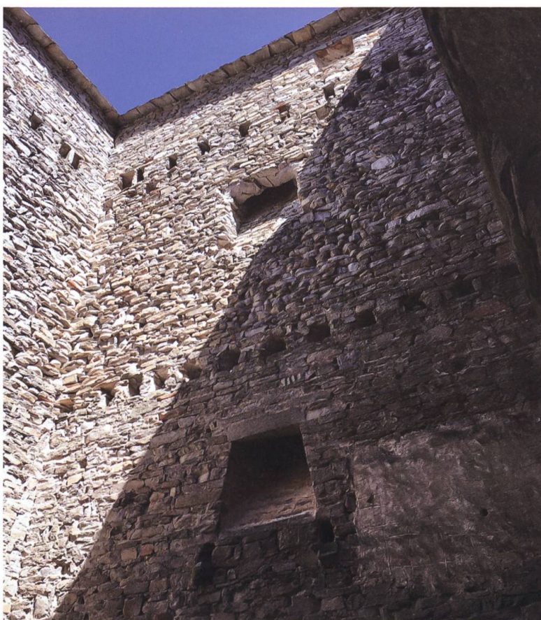
La parete interna nord. Al livello del 4° piano le tracce dell'esposizioni al calore sono ben riconoscibili. Foto: ADG/SAGR
