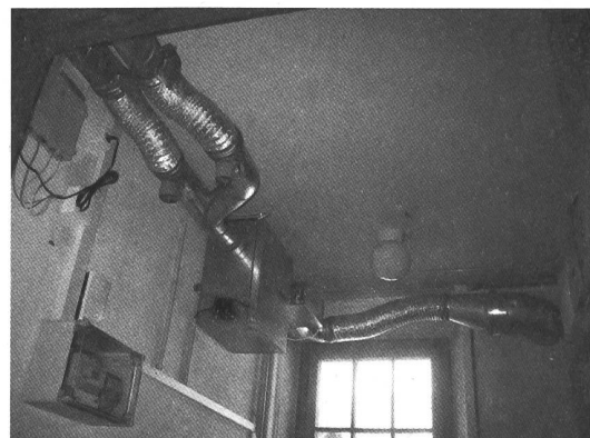
Figur 13 Ventilator und Steuerung in Nebenraum des Kindergartens
