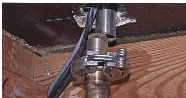
Du 17 juillet au 10 octobre (85 jours), les mesures du moniteur de Weissfluhjoch ont dû être invalidées à cause de l'endommagement de la ligne d'aspiration suite à la réfection de l'étanchéité du toit. Ainsi, l'air mesuré a été un mélange d'air intérieur et extérieur du bâtiment.
