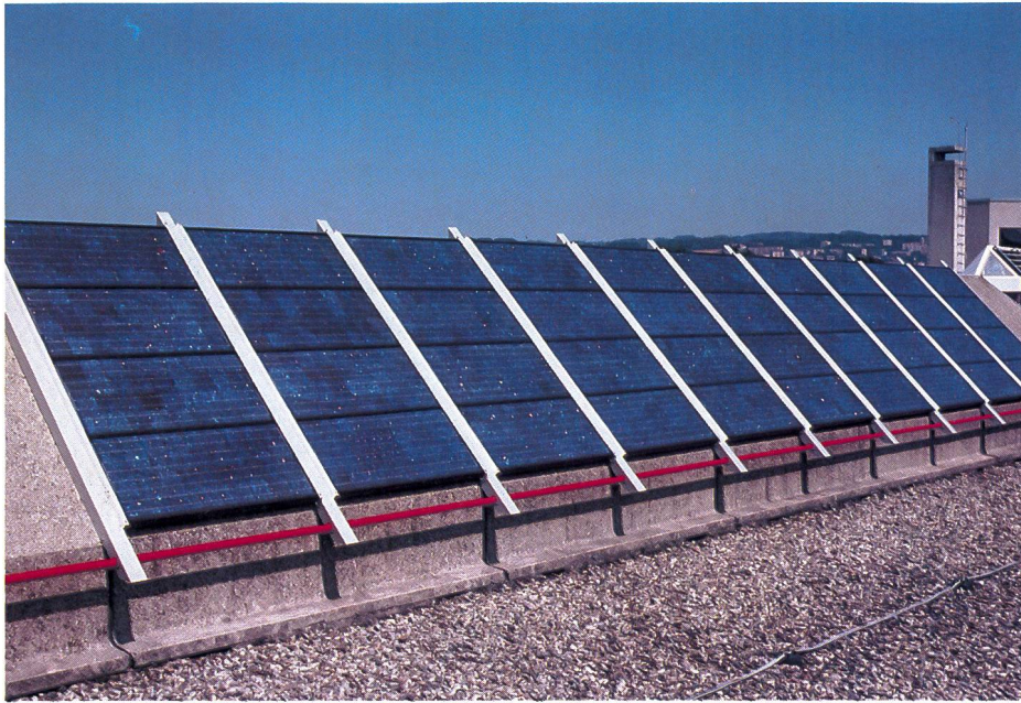
Integration der photogalvanischen Architektur: Installation von 3 KW, am Netz angeschlossen und auf ein Dach der ETH Lausanne montiert.
