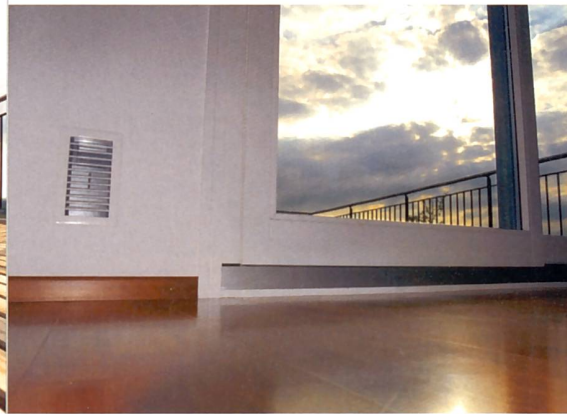
Auf diskrete Weise erfolgt die Luftzufuhr in die Wohnräume.
