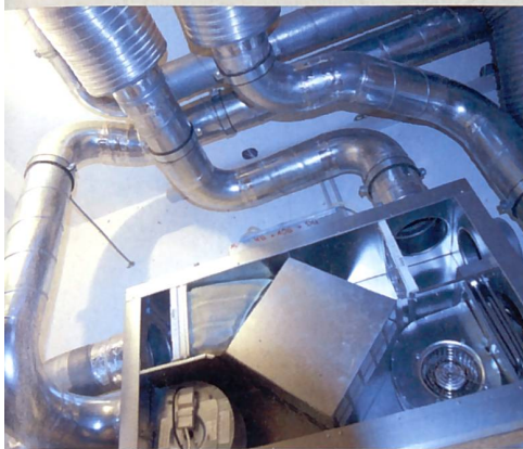
Das Kernstück der Komfortlüftung: im Heizungskeller wird Frischluft angesaugt.
