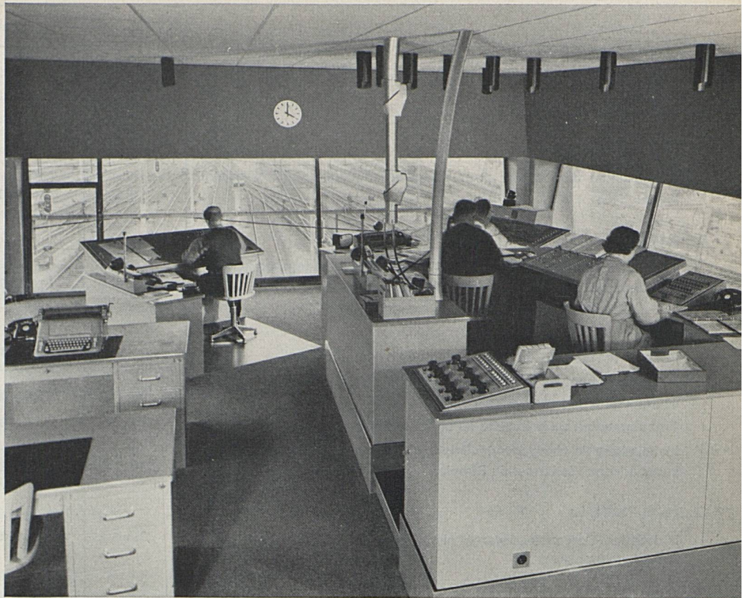
Poste de commandement du nouvel enclenchement de Bâle – A droite, en avant, la speakerine, au milieu, le chef de la circulation des trains et, au fond, devant les tableaux, les aiguilleurs
