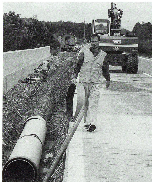
In der Schutzzone 2 wird unterhalb der New Jersey Mauer das doppelwandige Rohrsystem verlegt.
