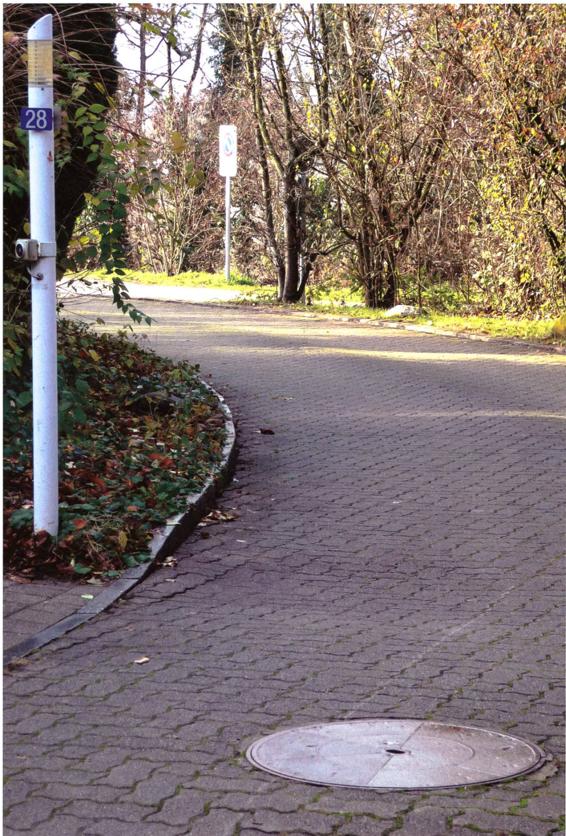
In diesem Schacht, «Alte Saline 28», sind die Soleleitungen der Salinen Rheinfeldens und Riburg verbunden.
