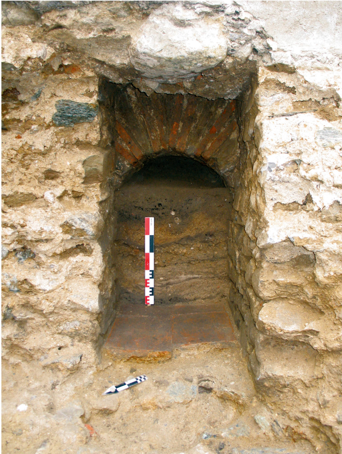
18 Nyon – Rue du Collège 27. Vue de la voûte à la jonction entre les deux égouts (photo Archeodunum SA).
