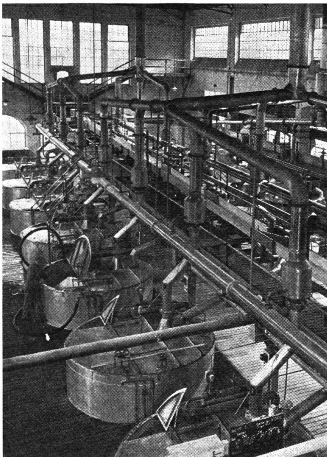
Fabrique fédérale de poudre, Wimmis. Stabilisation de la nitrocellulose.
