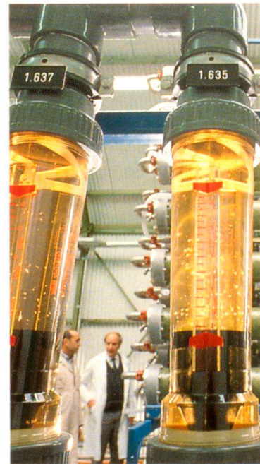
Nouveau dispositif d'ultrafiltration: les techniciens sont à la recherche de procédés assurant la purification optimale des eaux usées.
