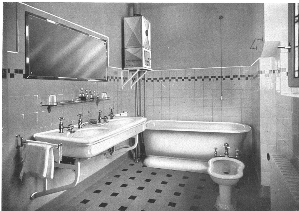
Aus dem Badezimmer einer Villa in St. Gallen. Sanitäre Einrichtungen von Bamberger, Leroi & Co., Zürich und Frankfurt a. M. Installationen durch die Firma Altorfer, Lehmann & Cie., St. Gallen. Aufnahme von Schmidt, St. Gallen.
