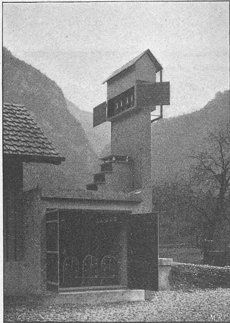
Fig. 17. Transformatoren-Station bei Dallenwyl.
